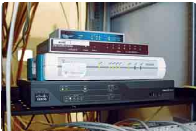
Bild 3: Der zentral installierte FL MGuard Delta (zweites Gerät von oben) nimmt sämtliche VPN-Verbindungen entgegen.
